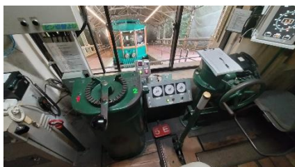
旧 運転制御装置（運転台）
