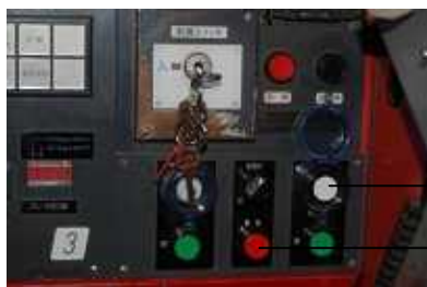
(乗務員室操作盤)
